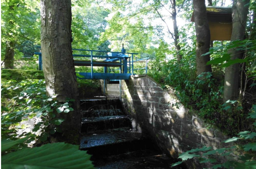
Bild 1: Schleuse zur Wassermengenregulierung
